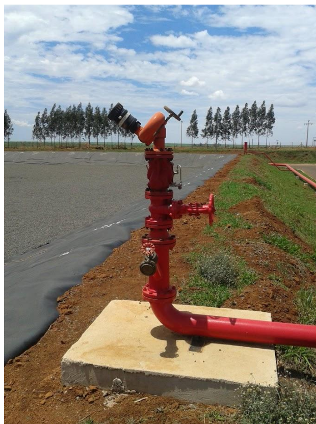
Novo sistema de incêndio projetado já executado para a mesma usina.
